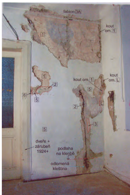
Obr. 20. Nálezové situace v omítkách. Indikátorem byly praskliny, rozšířené na sondy. Jde o JZ kout v 1. patře domu č. p. 387 v Praze – Malé Straně. Zdivo a omítky nalezené v sondě náležejí jak bývalému kostelu, tak nájemnímu domu, na nějž byl přestavěn. Doporučeným uspořádáním získaných informací je a byl v daném případě Harissův diagram stratigrafické posloupnosti, viz kap. 10. 5.
