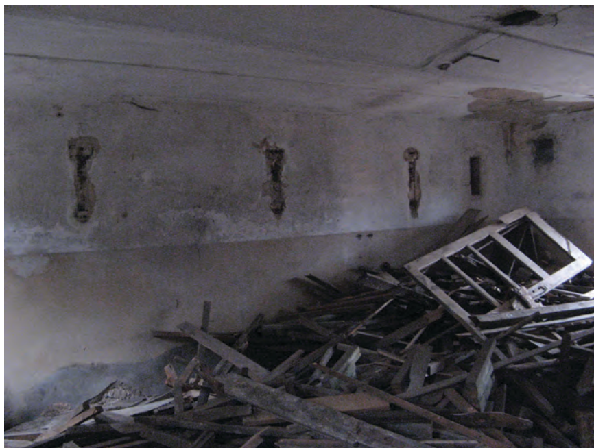
Obr. 16. Týnec nad Labem č. p. 2. V bývalé stáji na dvoře domu (kdysi vrchnostenského) byla ve 20. letech 20. stol. zřízena výrobní uzenin: dochovaly se kotle, stopy po transmisii a traverzový rám pro stacionární elektro(?)motor, který v případě potřeby mohl pohánět i jiný stroj na dvoře.
