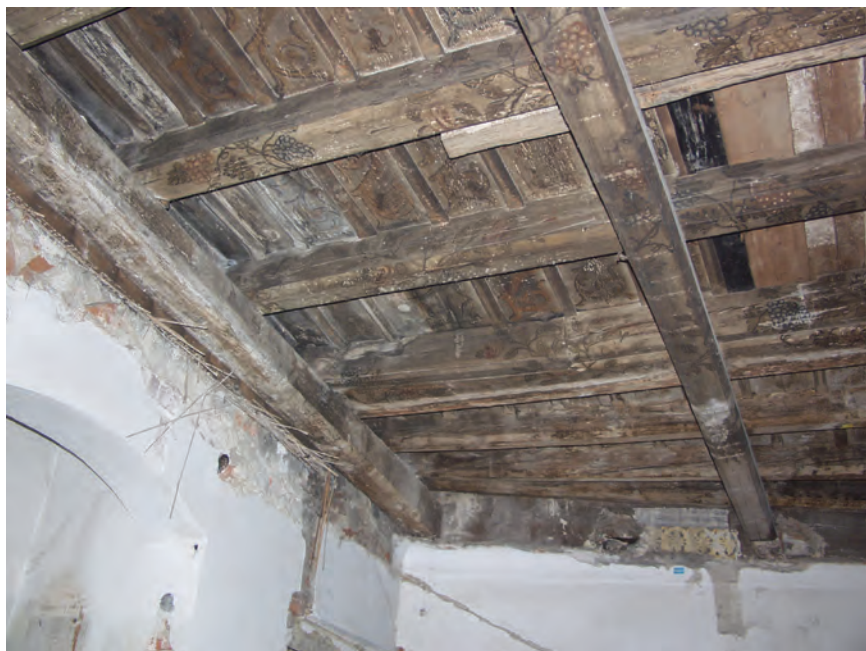
Obr. 22. Příklad složitější situace ve stropě: strop v patře malostranského domu. Strop vzniklý patrně nedlouho po požáru města byl z úsporných, poddimenzovaných profilů. Ještě v pozdní renesanci či raném baroku byl vyztužen a zároveň kompletně opatřen malbami s vínem.
